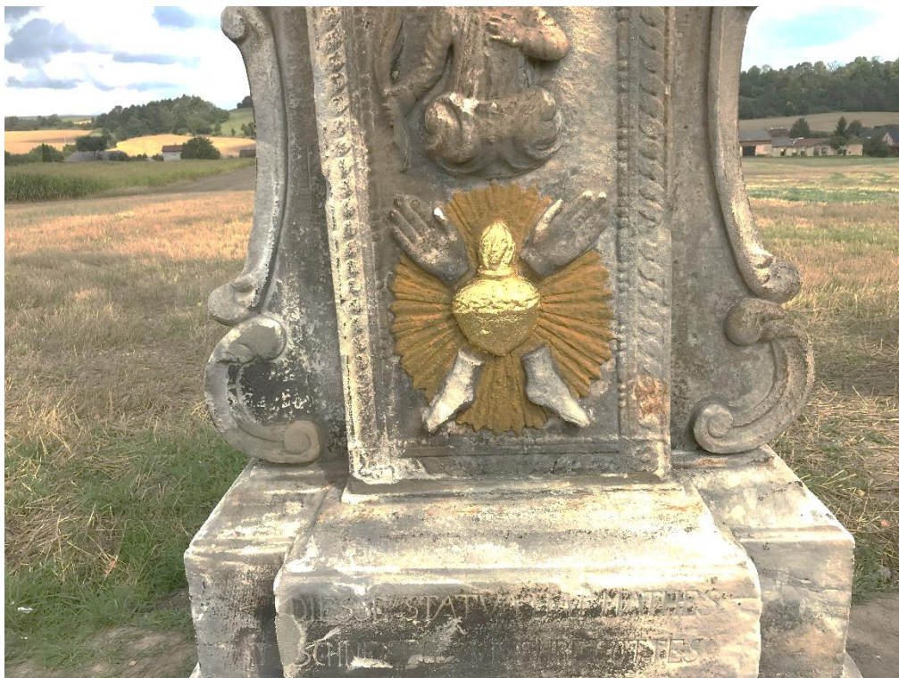
ROZSTÁNÍ, PILÍŘ SE SV. TROJICÍ, STAV PO OČIŠTĚNÍ, VYSPRÁVKY A TMELY POSTUP ZLACENÍ
