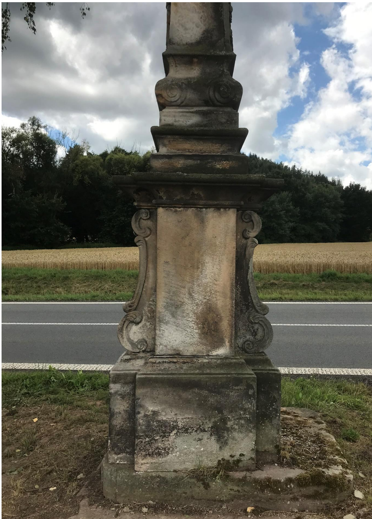
ROZSTÁNÍ, PILÍŘ SE SV. TROJICÍ, STAV PŘED RESTAUROVÁNÍM – ZNEČIŠTĚNÍ KAMENE, CHYBĚJÍCÍ MODELACE ARCHITEKTURY, CELÝ OBJEKT MIMO OSU ZÁKLADU
