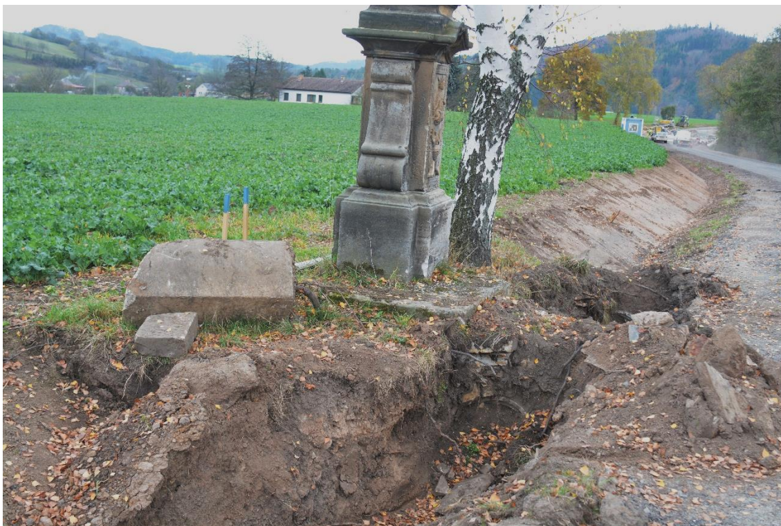
ROZSTÁNÍ, PILÍŘ SE SV. TROJICÍ, STAV PŘED RESTAUROVÁNÍM – POKLES A VYCHÝLENÍ, NARUŠENÉ PODLOŽÍ, CELÝ OBJEKT MIMO OSU ZÁKLADU
