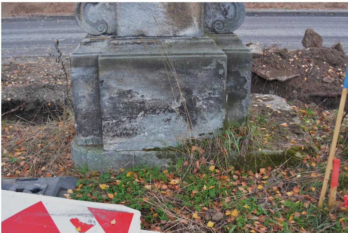
ROZSTÁNÍ, PILÍŘ SE SV. TROJICÍ, STAV PŘED RESTAUROVÁNÍM – POKLES A VYCHÝLENÍ, NARUŠENÉ PODLOŽÍ, CELÝ OBJEKT MIMO OSU ZÁKLADU
