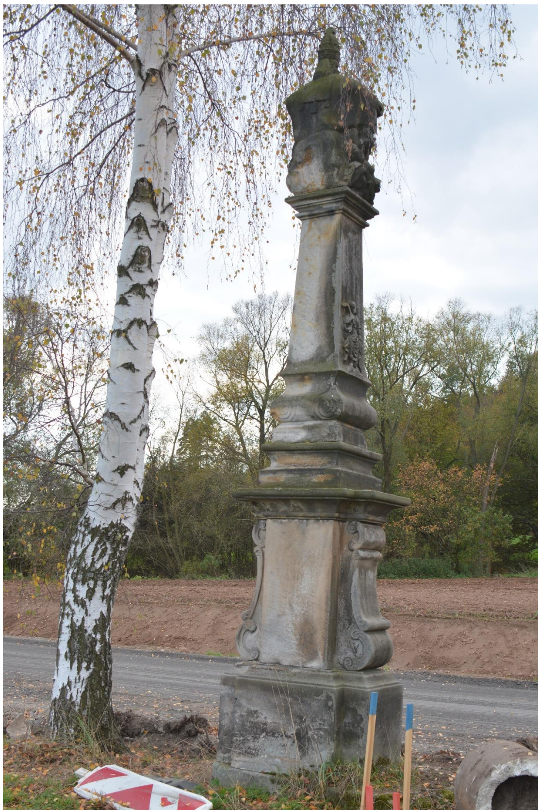
ROZSTÁNÍ, PILÍŘ SE SV. TROJICÍ, STAV PŘED RESTAUROVÁNÍM - PILÍŘ S PODSTAVCEM OSOVĚ VYCHÝLEN, NESTABILNÍ OBJEKT, HROZÍ ZŘÍČENÍ
