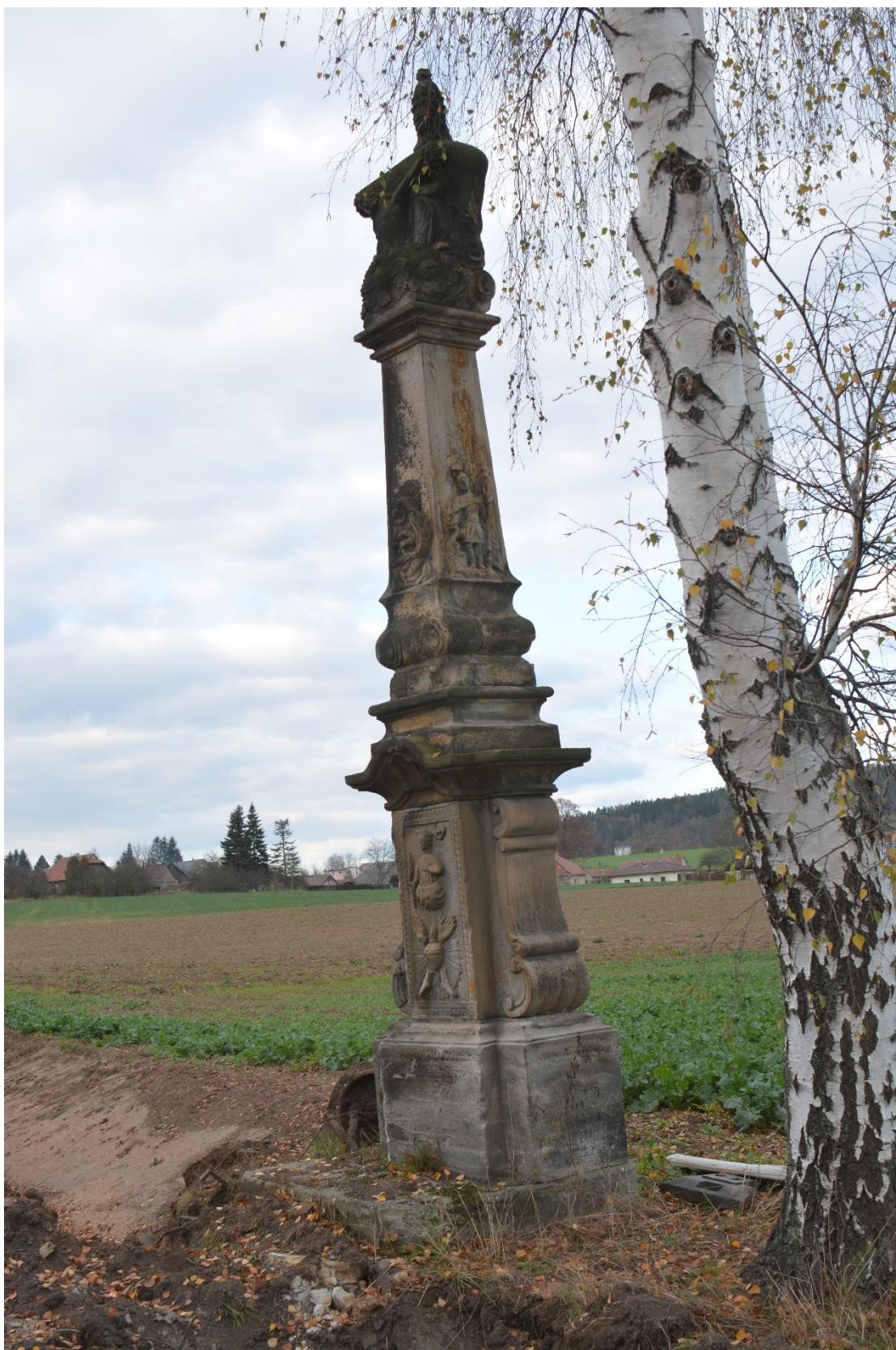
ROZSTÁNÍ, PILÍŘ SE SV. TROJICÍ, STAV PŘED RESTAUROVÁNÍM - PILÍŘ S PODSTAVCEM OSOVĚ VYCHÝLEN, NESTABILNÍ OBJEKT, HROZÍ ZŘÍČENÍ
