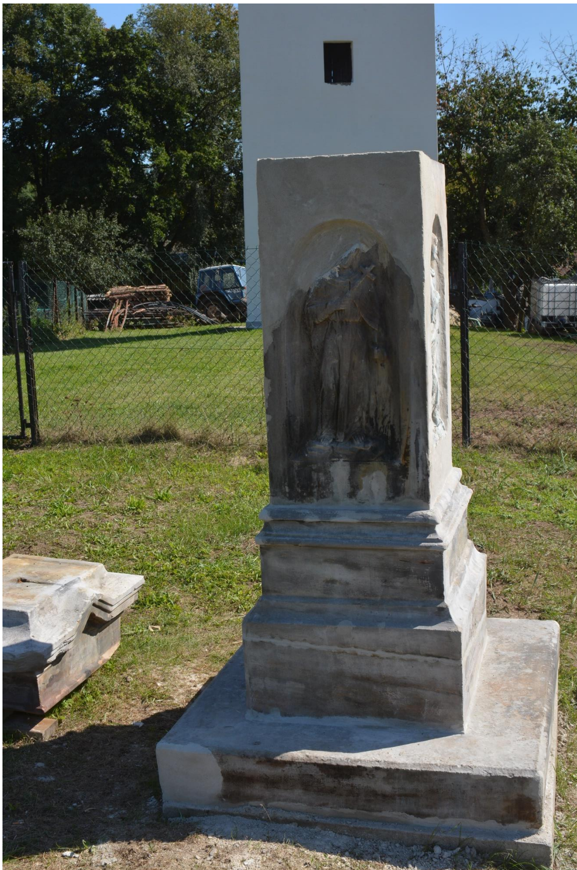
ROZSTÁNÍ – KŘÍŽ . SLOŽENÍ SPODNÍCH DÍLŮ NA NOVÝ ZÁKLAD PŘED ZVONICÍ V OBCI ROZSTÁNÍ, PO ZPEVNĚNÍ, OČIŠTĚNÍ A DOPLNĚNÍ CHYBĚJÍCÍ HMOTY
