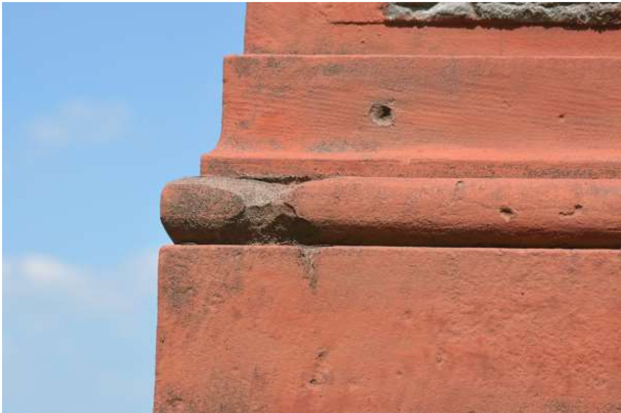
Rozstání, kříž na p.č.572/2, mechanické poškození kamene
