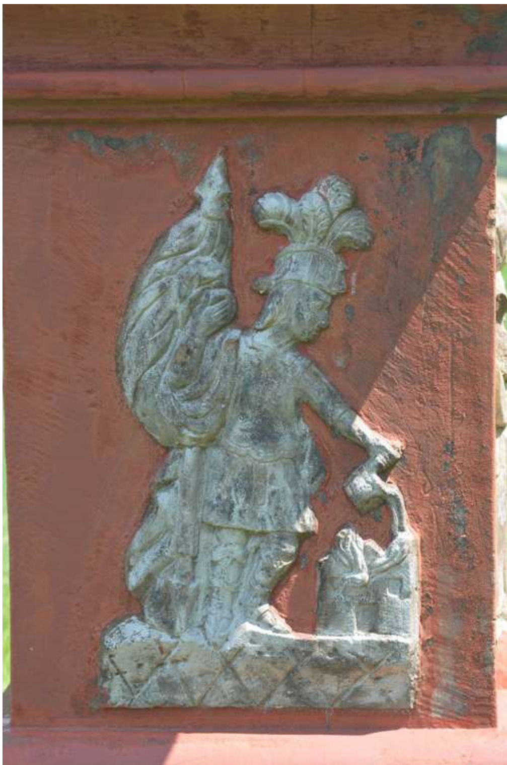
Rozstání, kříž na p.č.572/2, reliéf se sv. Floriánem, vrstvy nevhodných nátěrů na původním zlacení, kámen koroduje pod nátěry
