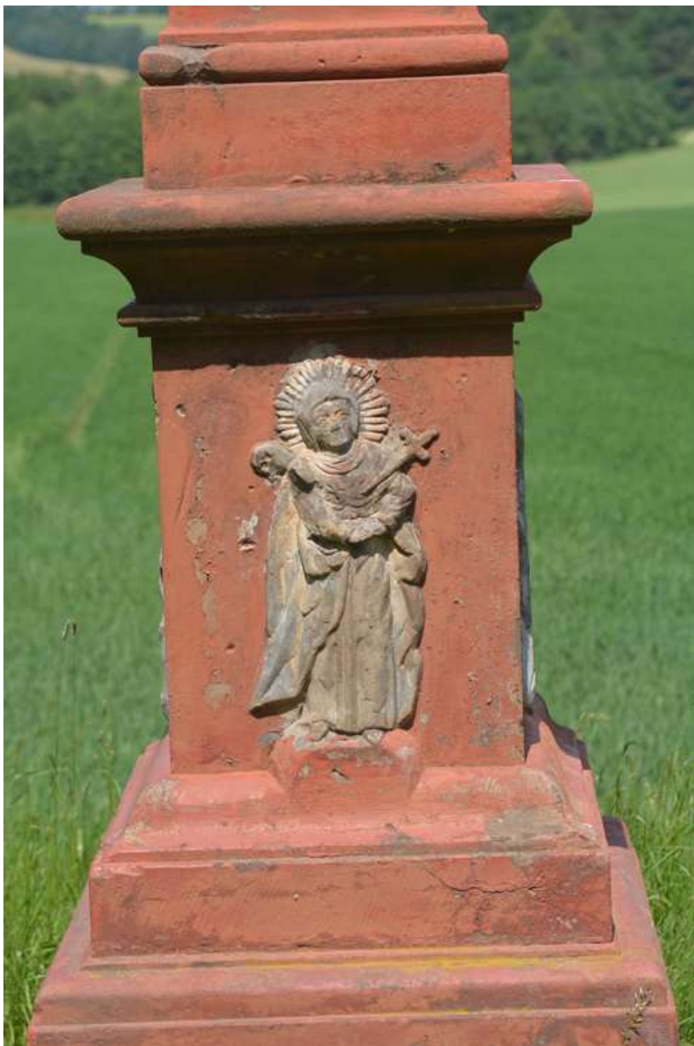
Rozstání, kříž na p.č.572/2, reliéf P.Marie Bolestné, nevhodný nátěr na původním zlacení, kámen koroduje pod vrstvami nátěrů
