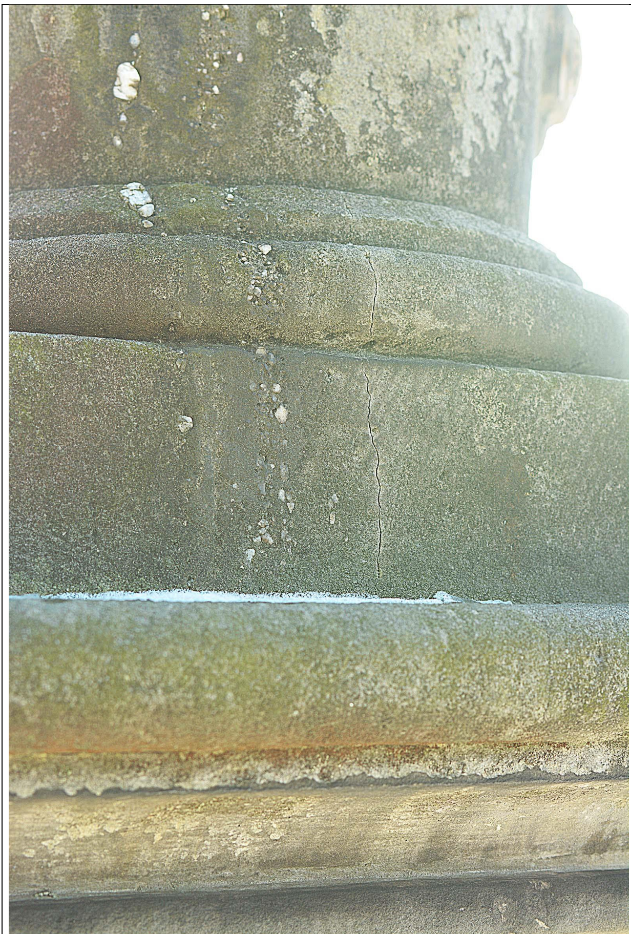
ROZSTÁNÍ - SOUSOŠÍ NEJSVĚTĚJŠÍ TROJICE, parc.číslo 169/2 TRHLINY V PATCE SLOUPU
