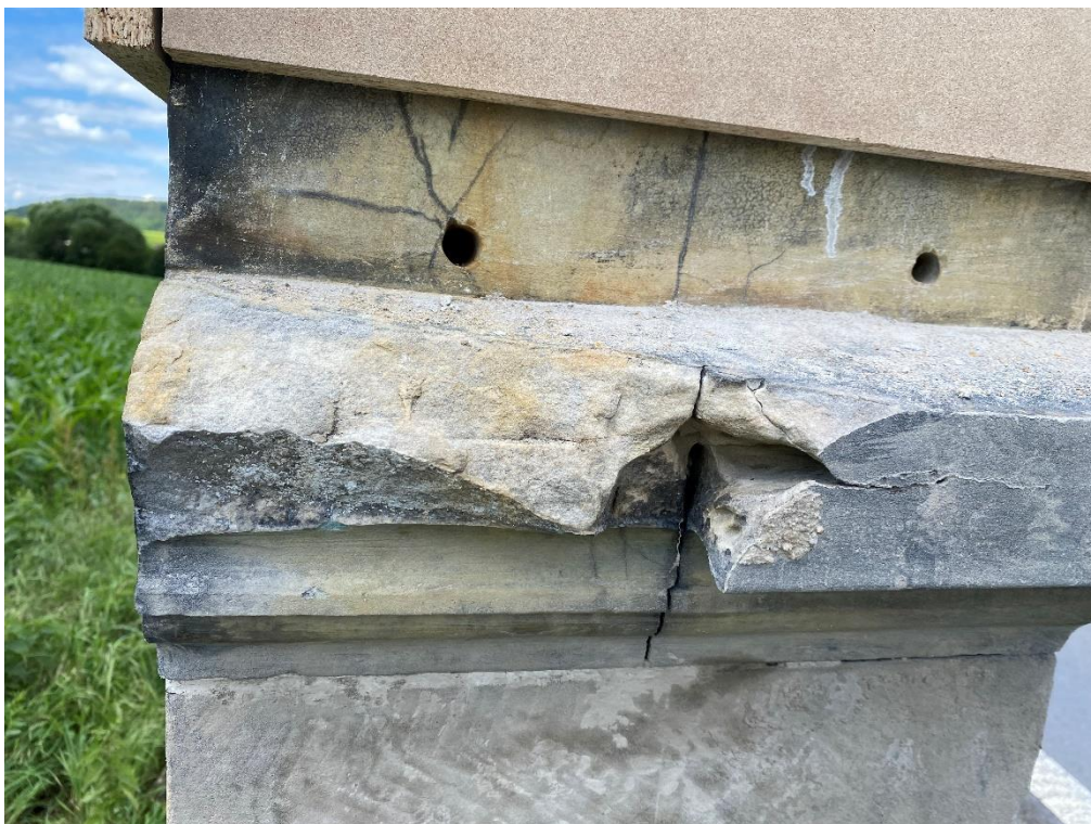
ROZSTÁNÍ – KŘÍŽ U SILNICE 371, ZPEVŇOVÁNÍ PRASKLÉ HORNÍ ČÁSTI, VRTY PRO SKLOLAMINÁTOVÉ ZPEVŇOVACÍ TYČE
