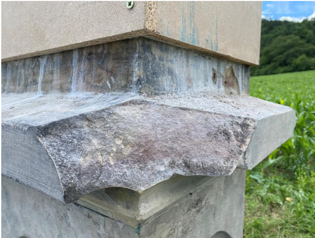
ROZSTÁNÍ – KŘÍŽ U SILNICE 371, DETAIL POŠKOZENÍ
