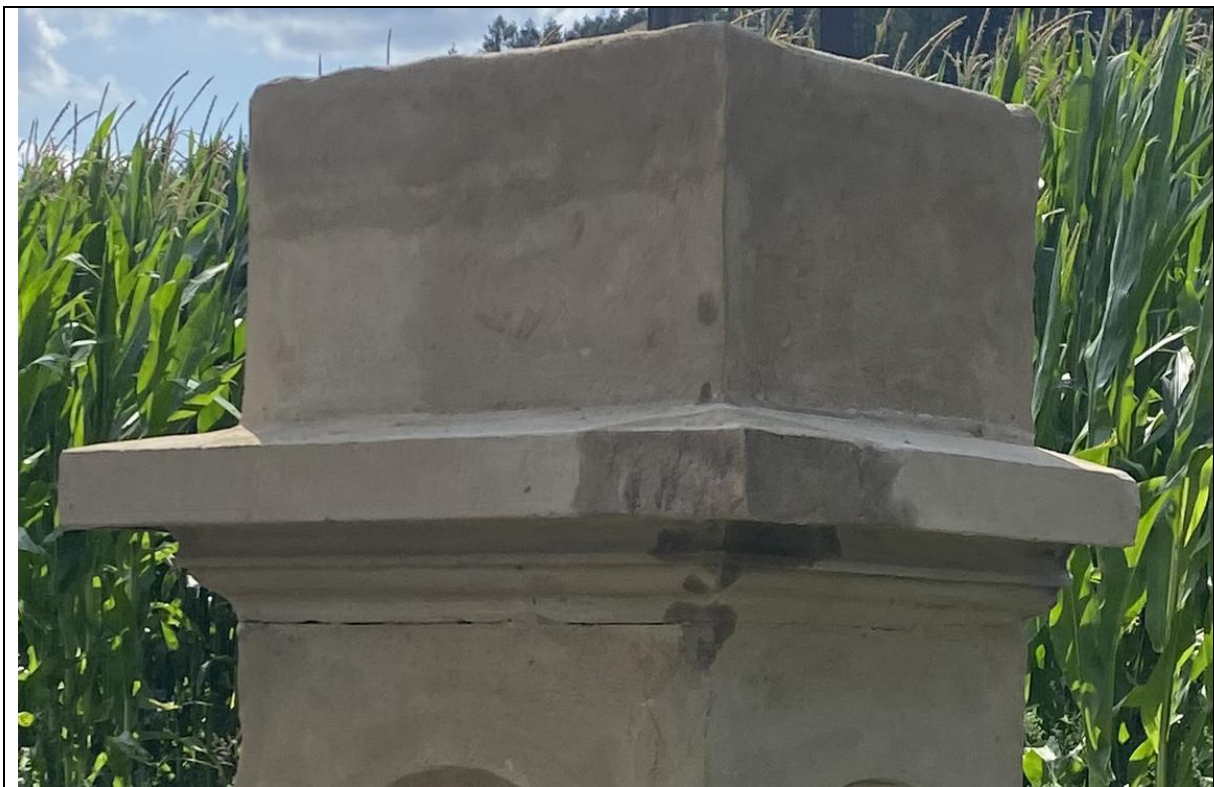
ROZSTÁNÍ – KŘÍŽ U SILNICE 371, DETAIL POŠKOZENÍ – OPRAVA (DOPLNĚNÍ) POŠKOZENÉ ČÁSTI
