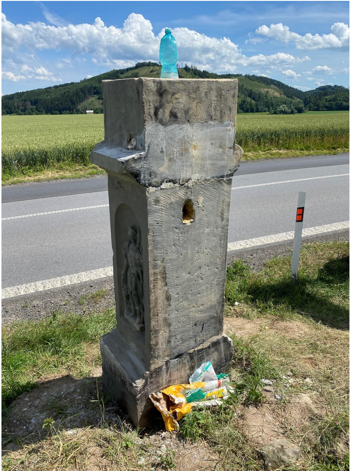
ROZSTÁNÍ – KŘÍŽ U SILNICE 371, OPRAVA-VÝMĚNA- POŠKOZENÉ HLAVICE
