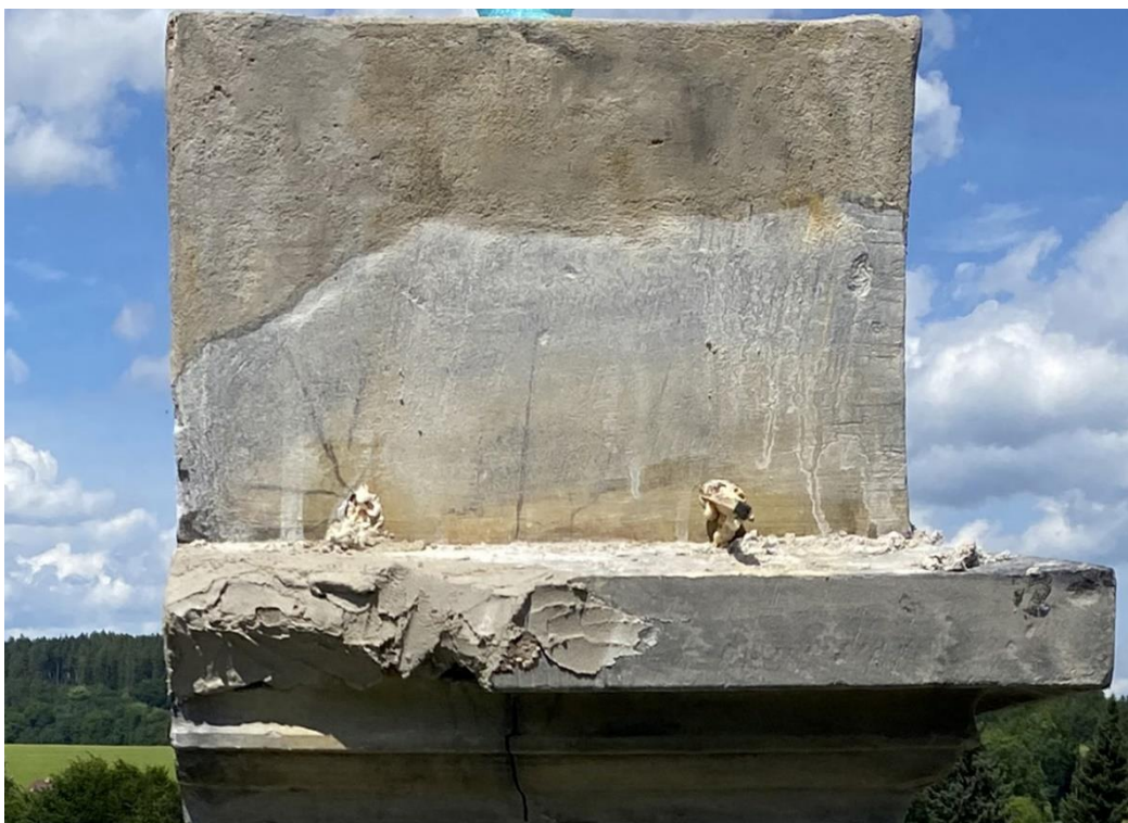
ROZSTÁNÍ – KŘÍŽ U SILNICE 371, ZPEVŇOVÁNÍ PRASKLÉ HORNÍ ČÁSTI, PROLEPENÍ SKLOLAMINÁTOVÝMI TYČEMI, TMELENÍ CHYBĚJÍCÍ HMOTY, NÁHRADA HMOTY ZA NEVHODNÝ BETON
