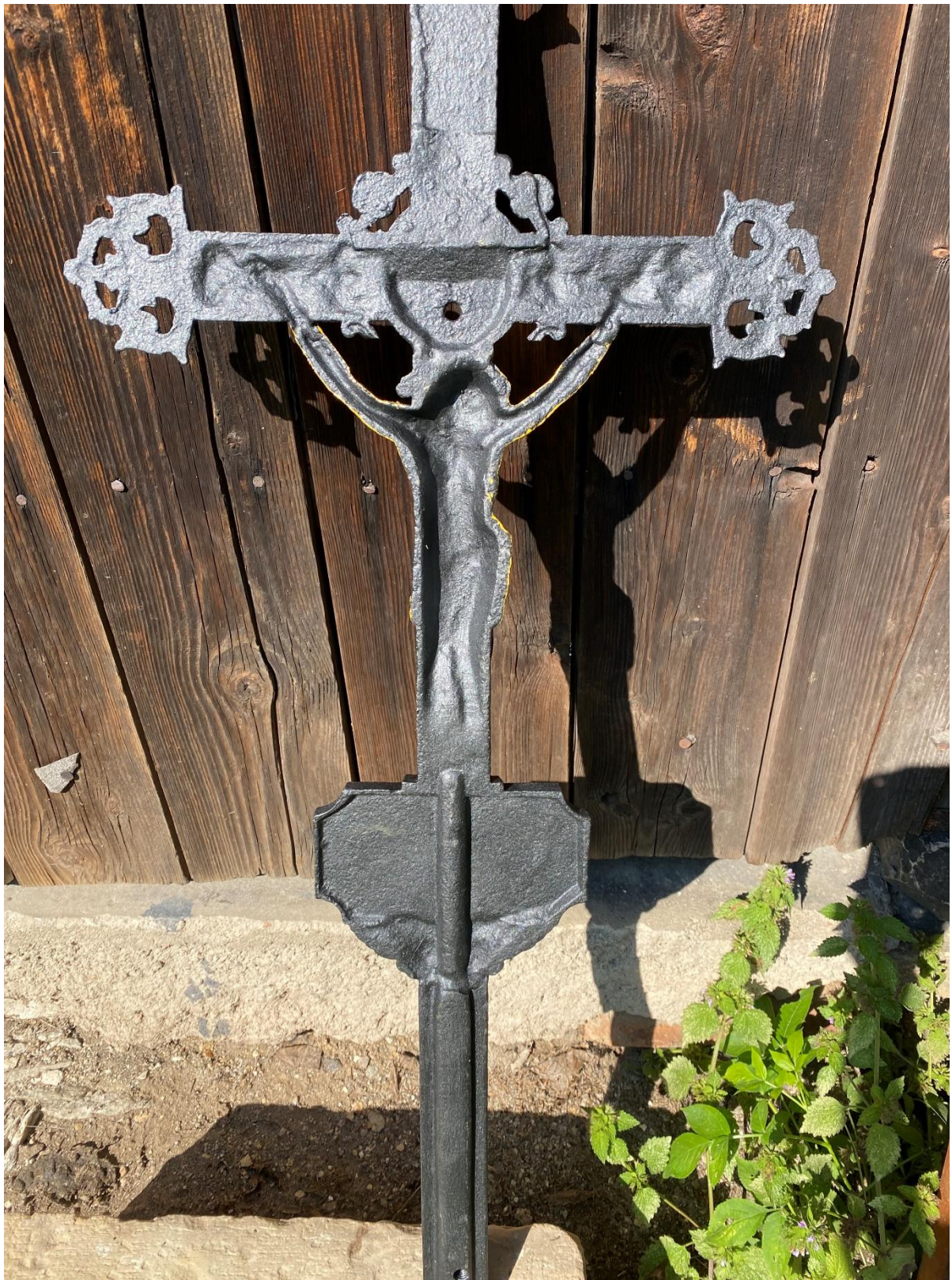
ROZSTÁNÍ – KŘÍŽ U SILNICE 371, STAV PO OČIŠTĚNÍ LITINOVÉHO KŘÍŽE, PO SPOJENÍ PRASKLÝCH ČÁSTÍ
